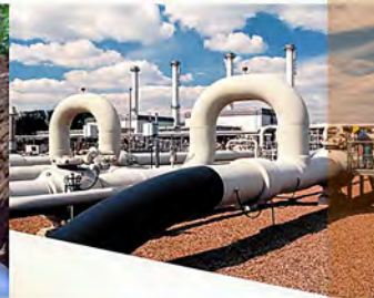
Fabricación de cabezales y trampas p/ gas seco
